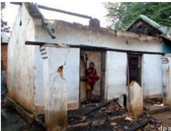
Ein von Radikalen zerstörtes Haus im Kandhamal-Distrikt
